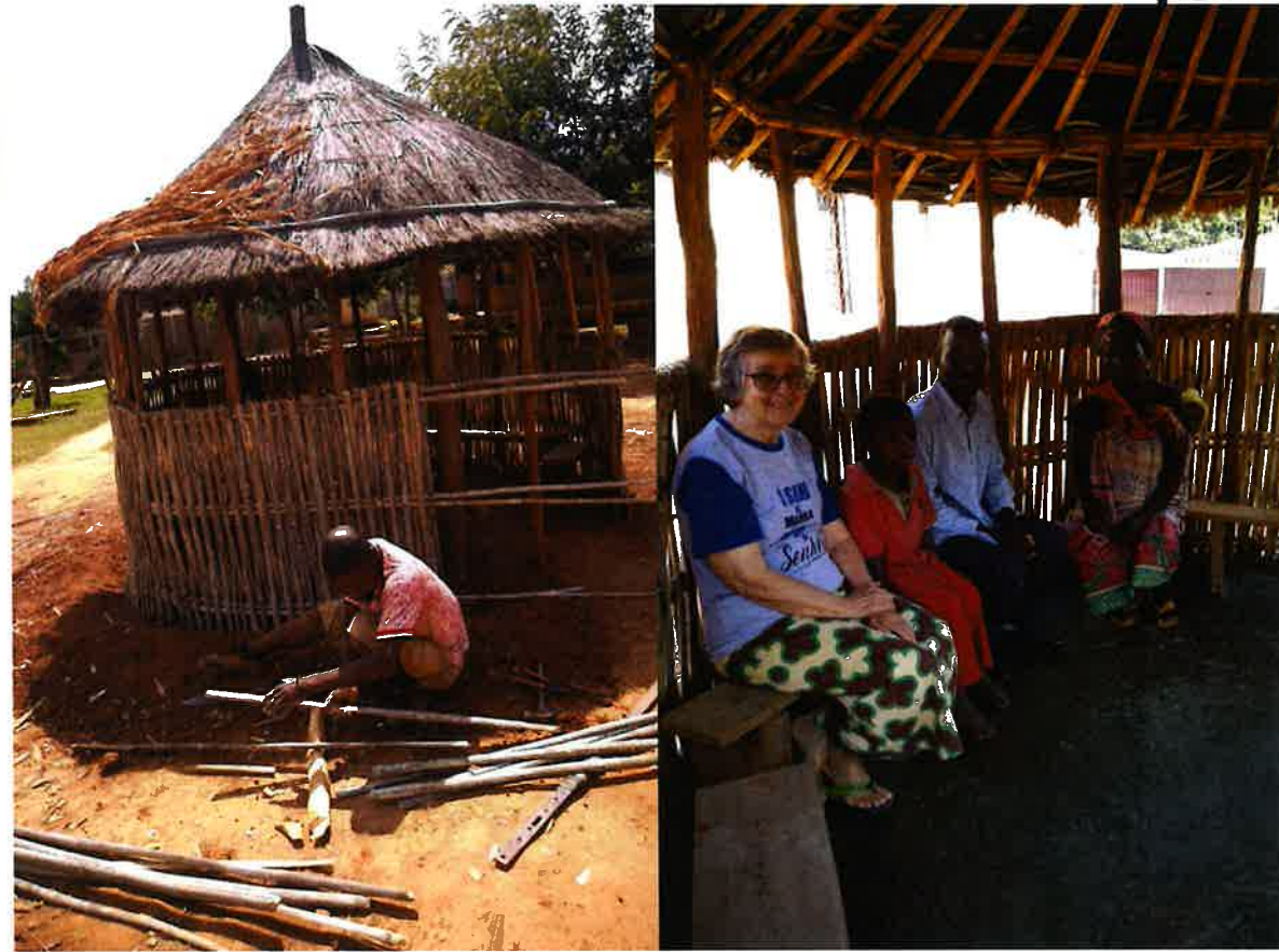
Renovação da machessa → serve de lugar para receber os convidados / hóspedes e lugar de aconselhamento
